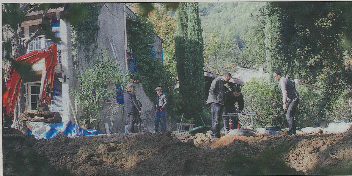
La mise aux normes de l'assainissement non collectif n'est obligatoire qu'en cas d'achat d'une propriété ou si l'installation est très polluante. (Photo doc. Eric Estrade)
